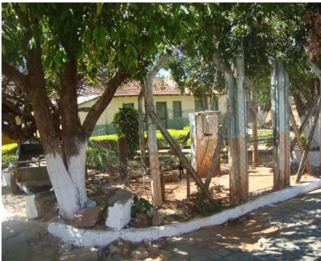
Poço Profundo – São Pedro das Tabocas
