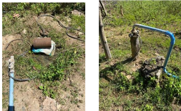
Figura 18 e 19 : Poços tubulares Fonte:CODANORTE,2022.
